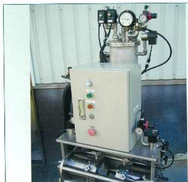
30 スラッジ脱水処理装置 メーカー 松下プラント
